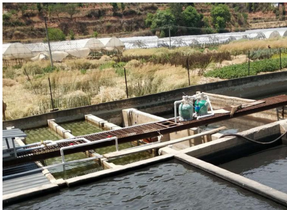
项目依托的 5m 3 /d 的污水处理站
