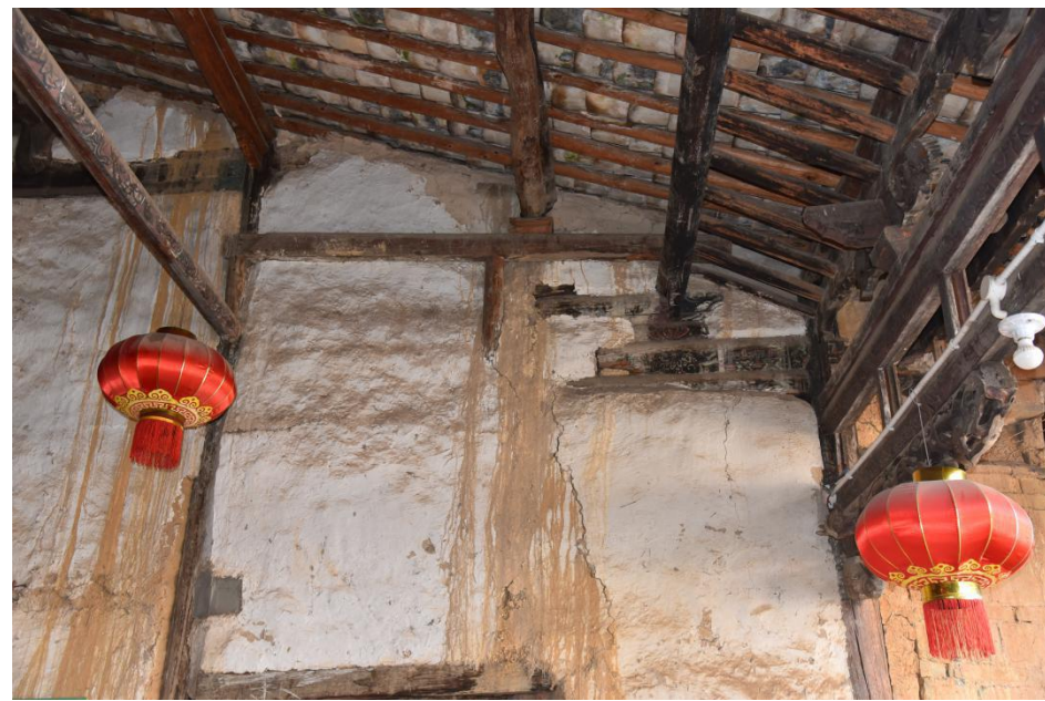
编号 20 墙面抹灰被泥浆污染，轩廊构件断裂 拍摄部位 东山墙前檐 拍摄日期 2019. 11. 26
