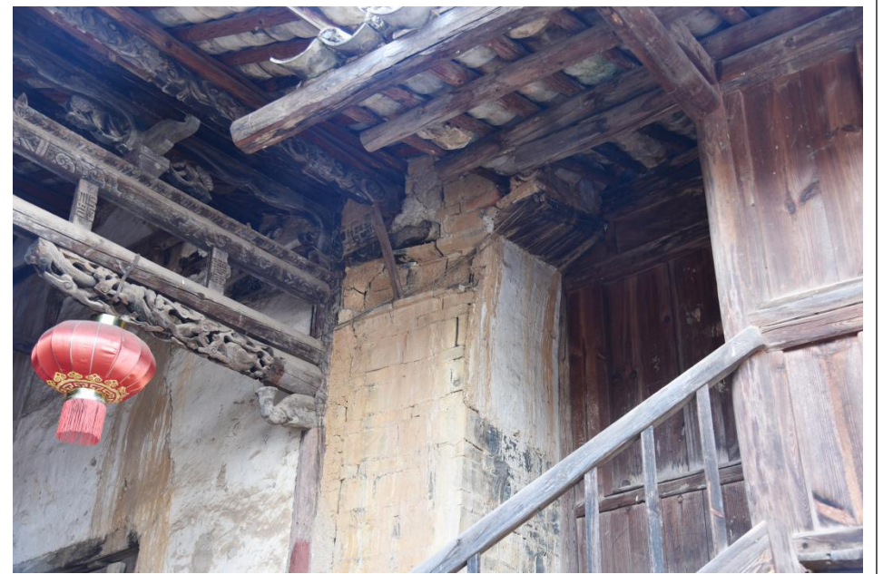
编号 21 墀头上部与厢房连接，青砖灰缝风化、脱落，表面被泥浆污染严重 拍摄部位 墀头 拍摄日期 2019. 11. 26
