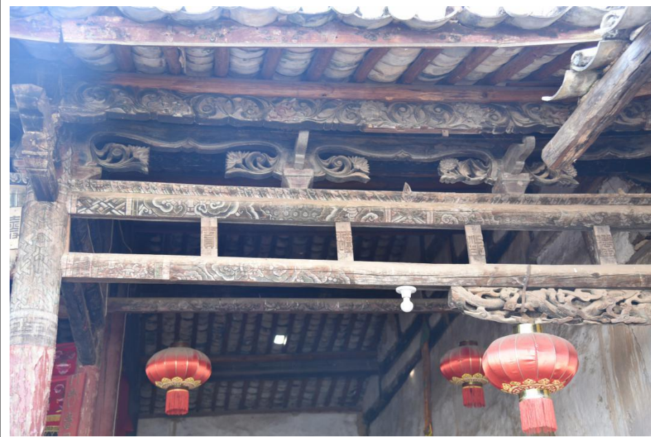
编号 23 东侧雀替缺失，花板已全部缺失 拍摄部位 东次间前檐 拍摄日期 2019. 11. 26
