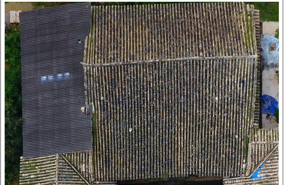
编号 06 正脊不顺直，窑制青灰瓦屋面酥碱、漏雨严重 拍摄部位 瓦屋面 拍摄日期 2018. 08. 13
