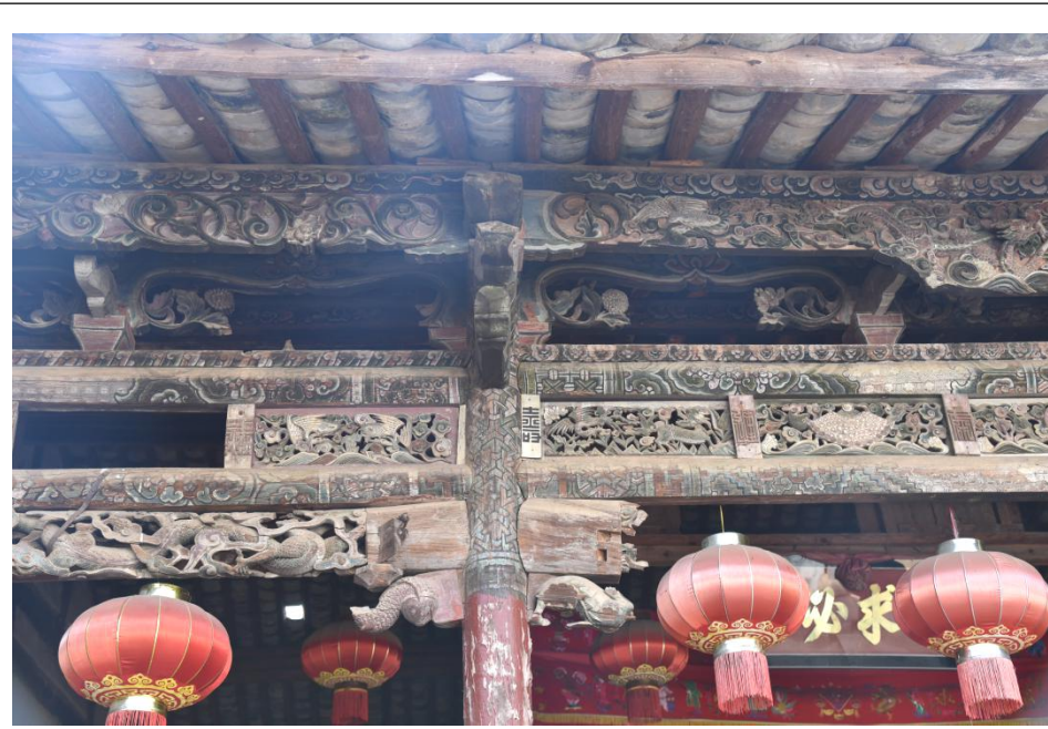
编号 19 明间前檐东侧雀替残损、缺失 拍摄部位 檐口木构件 拍摄日期 2019. 11. 26
