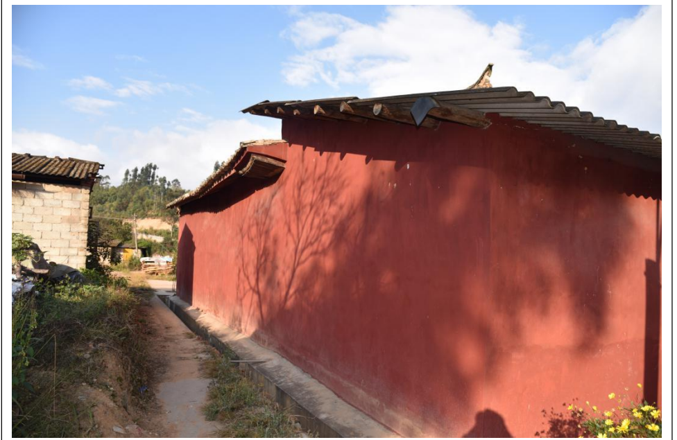
编号 03 铁红色外墙漆及后期搭建石棉瓦顶房 拍摄部位 背立面 拍摄日期 2019. 11. 26
