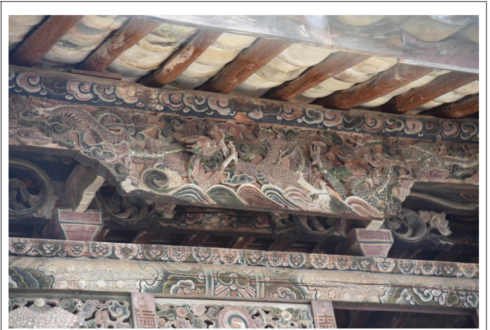
编号 21 彩绘褪色，表面积有灰尘 拍摄部位 檐口木构件 拍摄日期 2019. 11. 26
