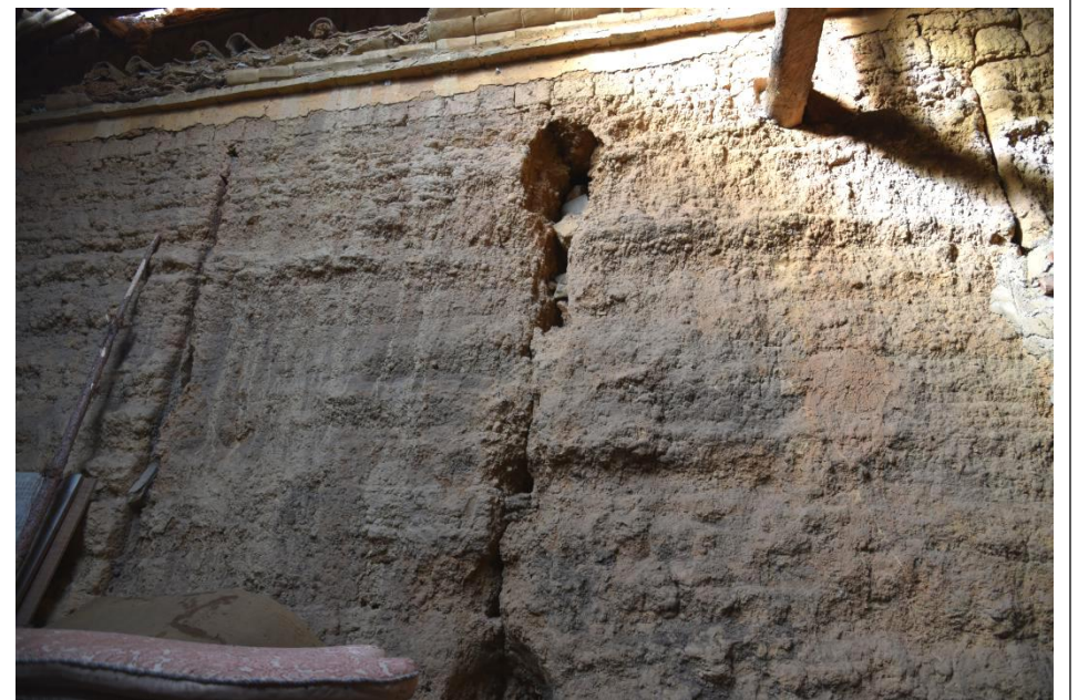
编号 24 夯筑土墙硝化严重 2.6 平方米，深 0.48m 一块 拍摄部位 西山墙外部 拍摄日期 2019. 11. 26
