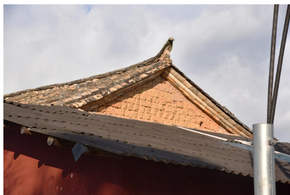
编号 05 墙面抹灰脱落，土坯砖裸露 拍摄部位 西侧山尖墙体 拍摄日期 2019. 11. 26
