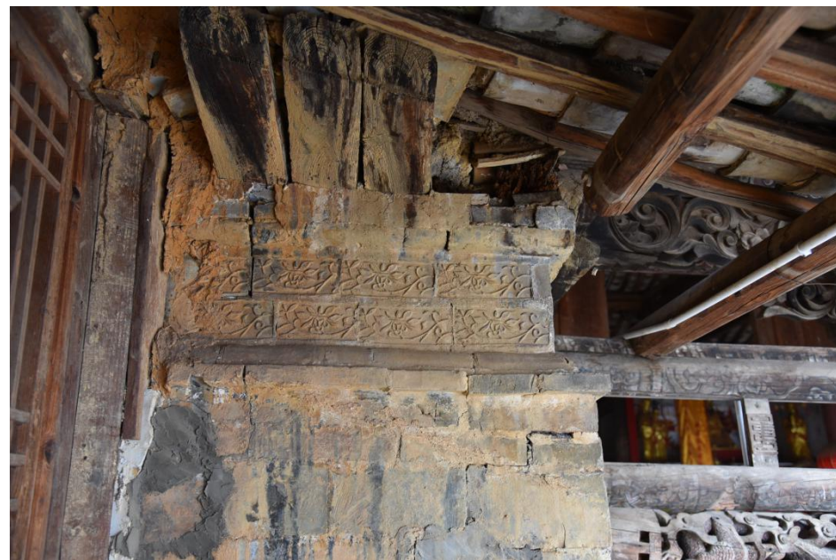
编号 22 青砖墀头墙疏松严重 拍摄部位 墀头上部 拍摄日期 2019. 11. 26
